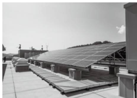
庁舎屋上太陽光発電設備
